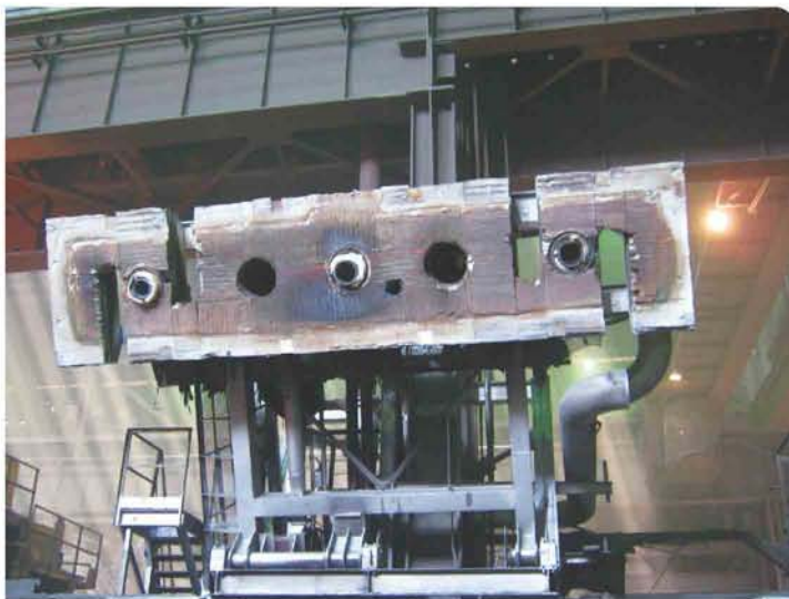
Фото 1. Крышка стенов разогрева проковшей («ЕВРАЗ НТМК») Heating stand's cover («EVRAZ NTMK»).
